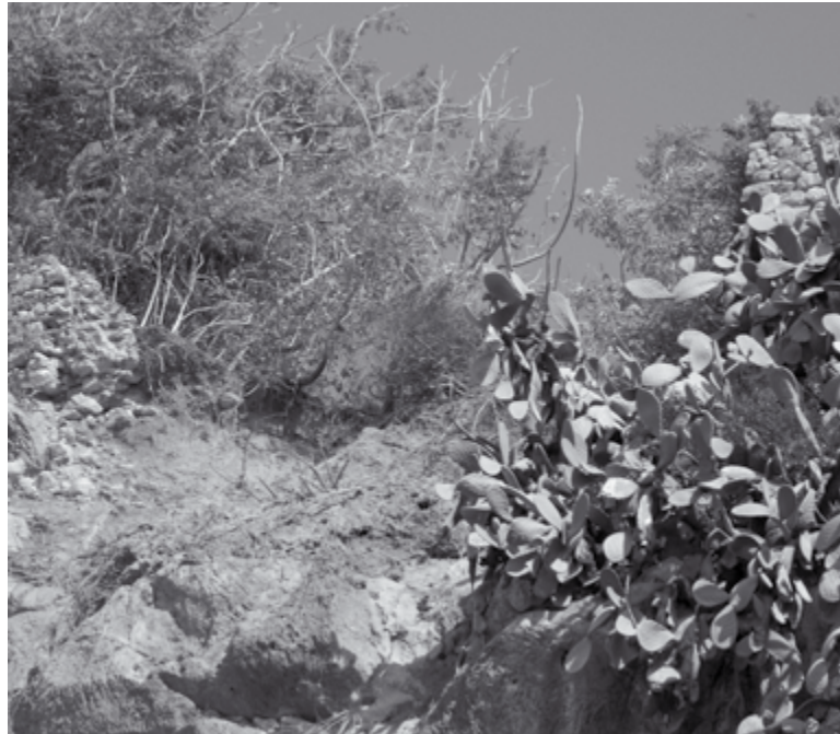
Κατάρρευση του ενετικού τείχους, γενική άποψη
