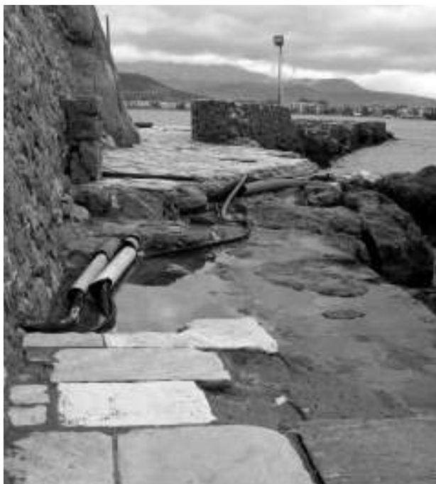
Τα επικίνδυνα ηλεκτροφόρα καλώδια στην κοινή θέα
